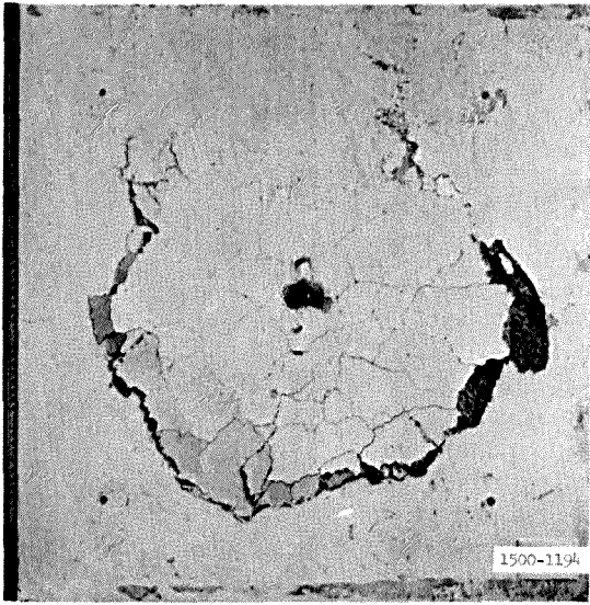
a. Crack pattern.
