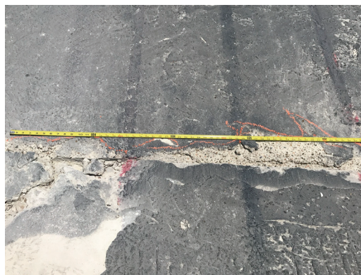
(d) Spalling on Quadrant #2 at 768 passes
