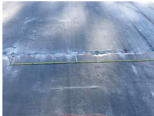
(d) Spalling in Quadrant #3 at 448 passes
